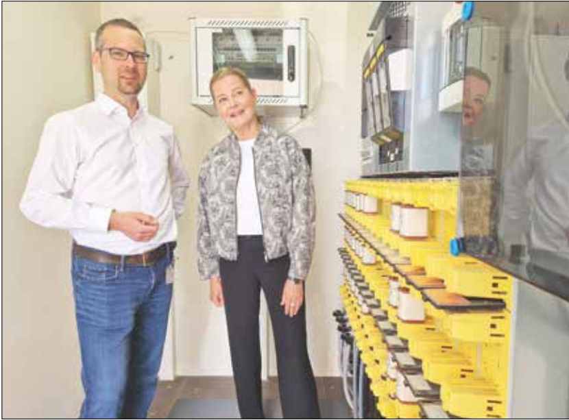
Prof. Florian Steinke von der TU Darmstadt und Ines Schultze (kaufmännische Vorständin e-netz Südhessen) begutachten einen Teil der technischen Ausstattung für das Projekt. Foto: ENTEGA AG
