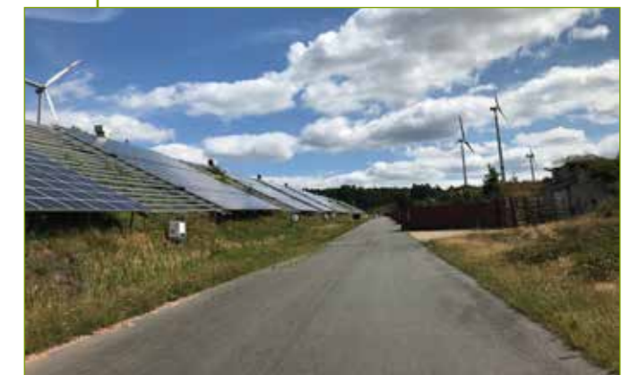
2,3 MW PV-Anlage auf einer verfüllten Bunkerreihe
