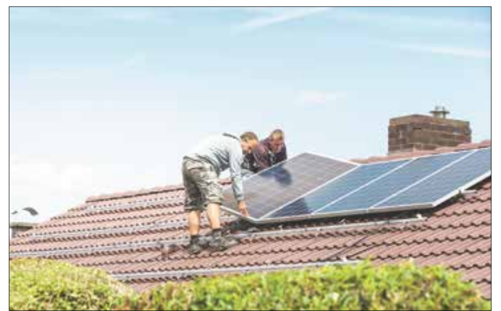
Eine Solaranlage auf dem eigenen Dach: ENTEGA macht es möglich. Foto: Simon Motz/ENTEKA
