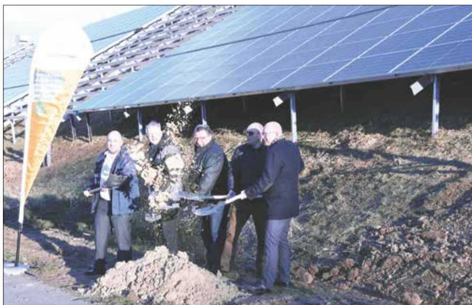
Vorzeige-Projekt: Gerd Schölller, Geschäftsführer von Schoenergie, OREG-Geschäftsführer Marius Schwabe und sein Stellvertreter Detlef Kuhn sowie der Lützelbacher Bürgermeister Uwe Olt und Landrat Frank Matiaske, (von links) beim Spatenstich für eine Photovoltaik-Anlage auf dem Hainhaus-Areal.
